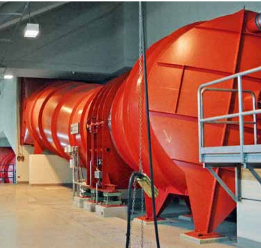
Ventilationssystem in den technischen Räumen eines Nationalstrassentunnels.
