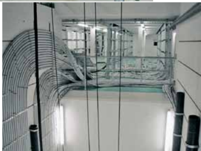
Ein grosser, begehbare Kabelkanal.
